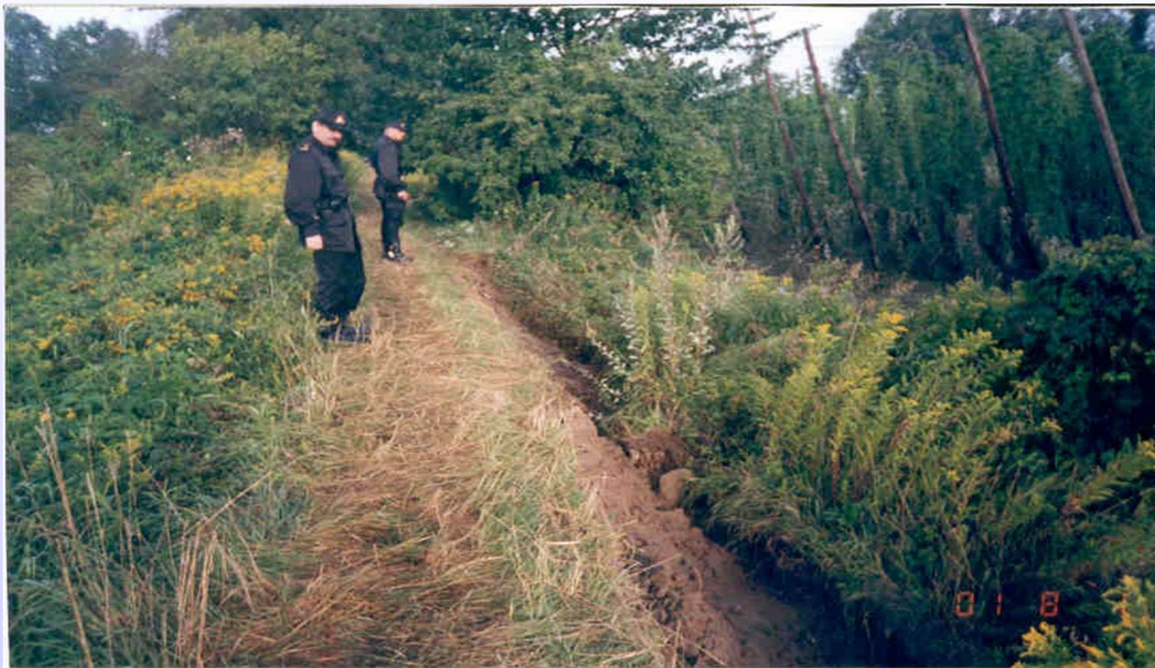
OSUNIĘCIE SKARPY WAŁU
